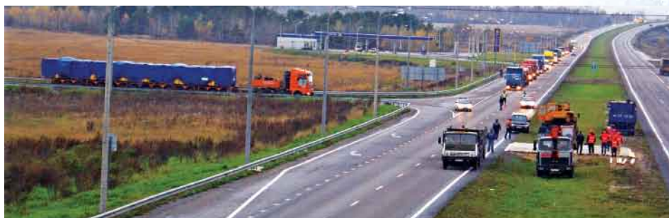
Фото 2. Приближение автотранспортного средства к участку федеральной автомобильной дороги, движение транспорта перекрыто сотрудниками ГИБДД
